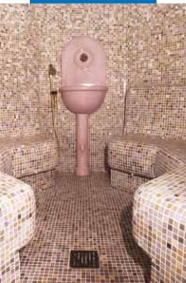
Esempio di posa di mosaico vetroso in un bagno turco - Park Hotel Gritti - Bardolino (VR)
