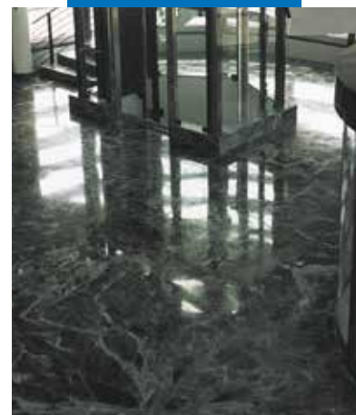
Postavljanje poda od zelenog mermera "Alpi" u upravnoj zgradi Rolex-a, Biene Švajcarska
